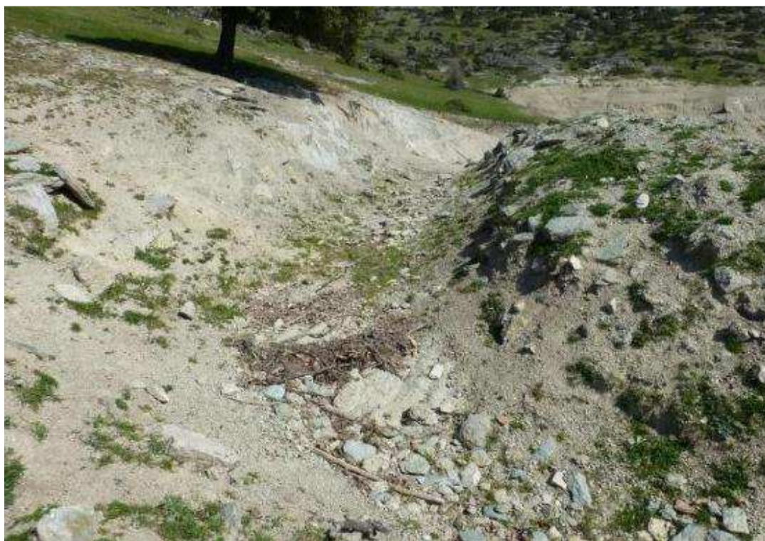
Φωτογραφία 27. Φράγμα Σπαρμού. Το κανάλι του υπερχειλιστή. Δεν υπάρχουν ίχνη πρόσφατης ροής.
