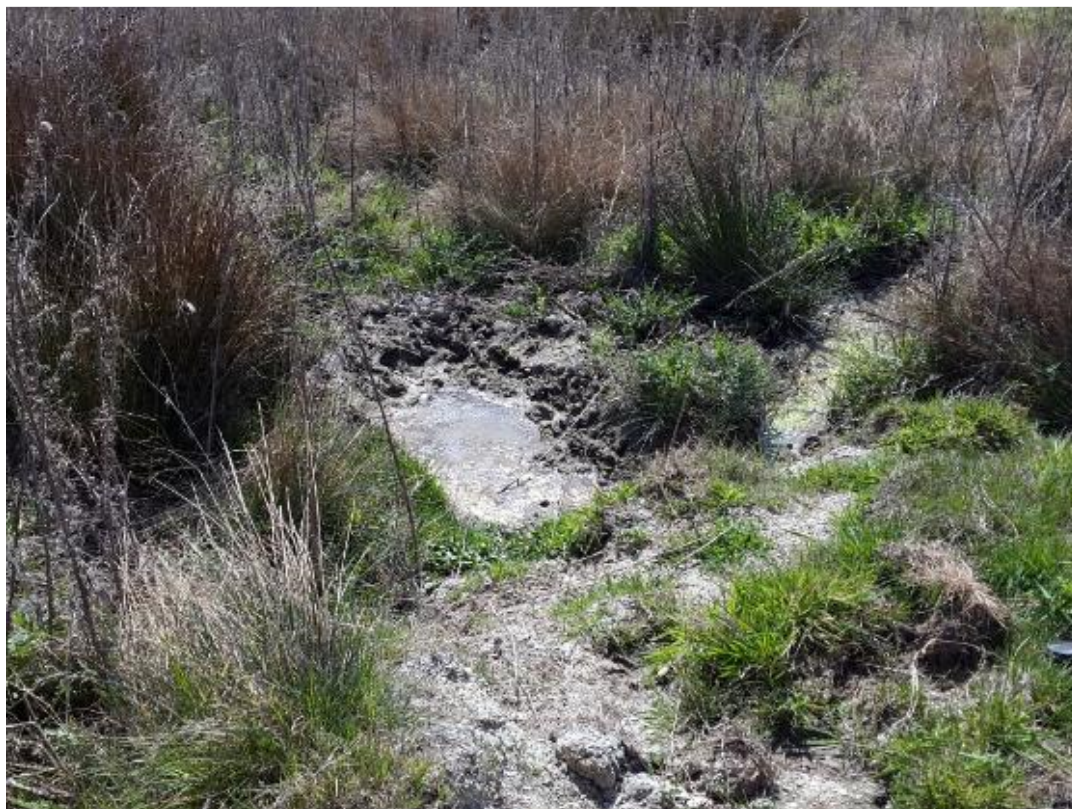
Φωτογραφία 24. Φράγμα Σπαρμού. Η κατάντη παρειά του φράγματος. Διακρίνονται λιμνάζοντα νερά και ανάπτυξη υδροχαρών φυτών.
