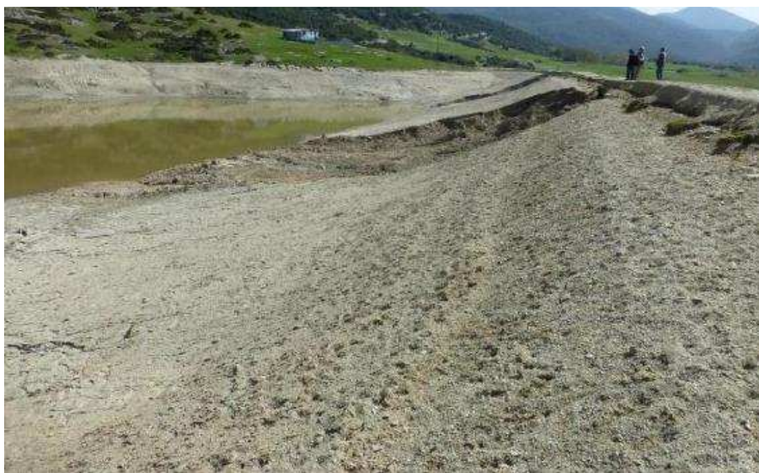
Φωτογραφία 29. Φράγμα Σπαρμού. Η ολίσθηση του ανάντη πρανούς λόγω απότομου καταβιβασμού της στάθμης.
