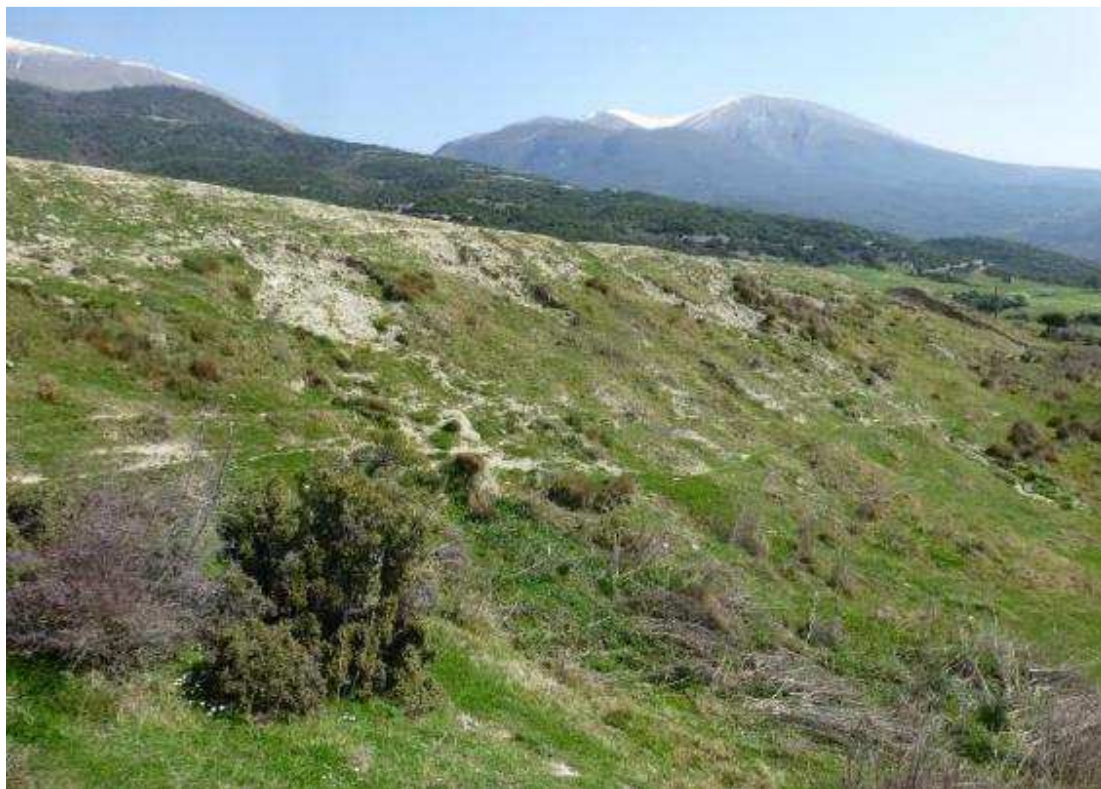
Φωτογραφία 22. Φράγμα Σπαρμού. Η κατάντη παρειά του φράγματος. Διακρίνονται νεροφαγώματα, μικρο-ολισθήσεις και ανάπτυξη υδροχαρών φυτών.
