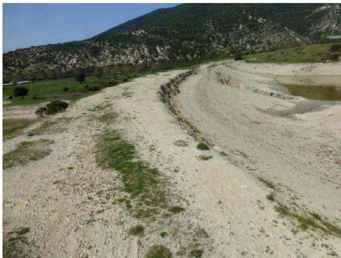
Φωτογραφία 13. Φράγμα Σπαρμού. Άποψη από το αριστερό αντέρεισμα. Διακρίνεται η θραύση και η ανάντη ολίσθηση
