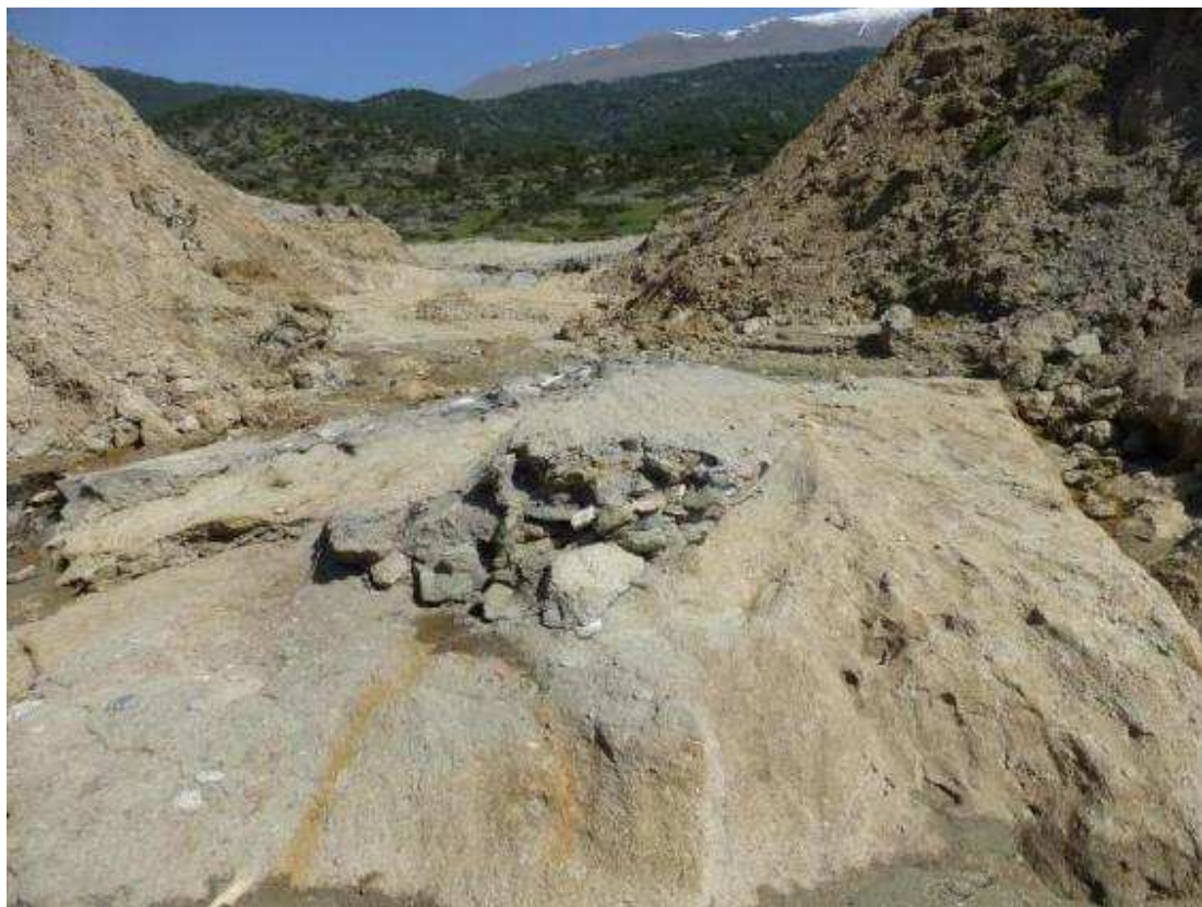
Φωτογραφία 16. Φράγμα Σπαρμού. Ο πυθμένας του καναλιού της θραύσης από καπάνη.
