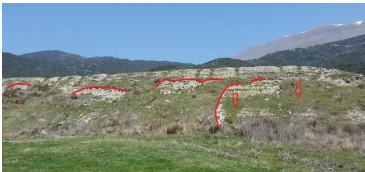
Φωτογραφία 23. Φράγμα Σπαρμού. Η κατάντη παρειά του φράγματος. Σημειώνονται οι, μικρο-ολισθήσεις.
